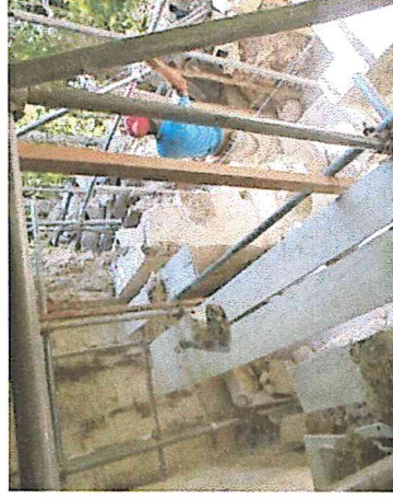
Foto No.37, Grietas en paramento Norte Ya terminado.
